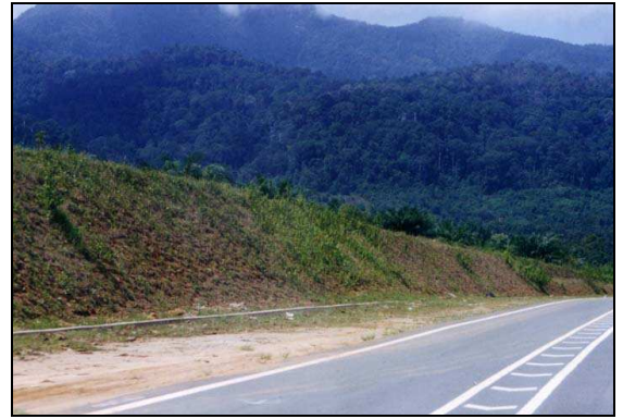
Gambar 8.6: Penanaman tanaman tutup bumi di atas cerun terpotong dapat mengelakkan hakisan permukaan cerun yang mungkin boleh menyebabkan ketidakstabilan cerun. (Jalan Persekutuan Gurun – Alor Setar – 14 November 2003)
