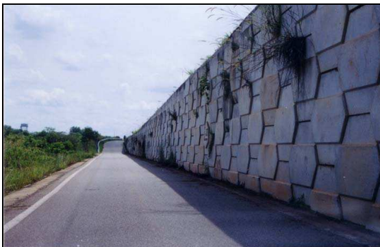
Gambar 8.5: 'Crib Wall' dapat mengelakkan dan menahan runtuh cerun. ( Susur keluar dari Taman Desa Enggang, Sungai Petani – 14 November 2003).
